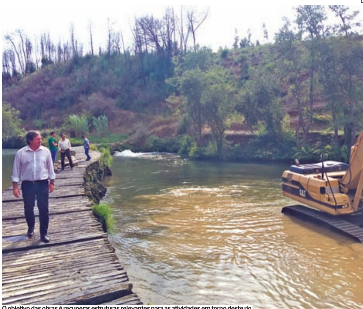
O objetivo das obras é recuperar estruturas relevantes para as atividades em torno deste rio
