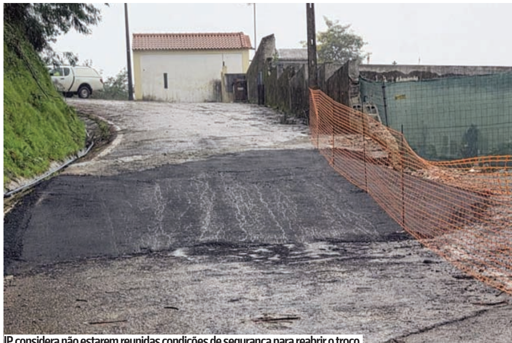
IP considera não estarem reunidas condições de segurança para reabrir o troço
